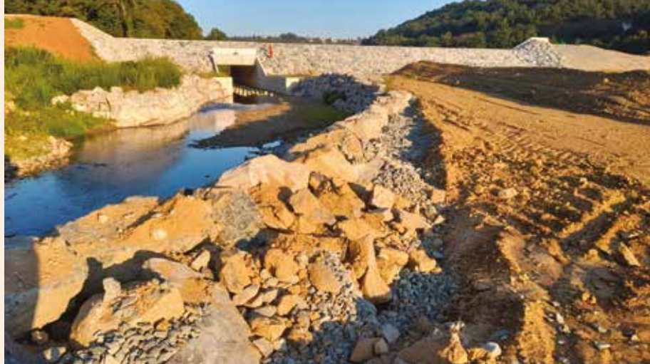
Barrage écreteur de crues sur la Turdine
